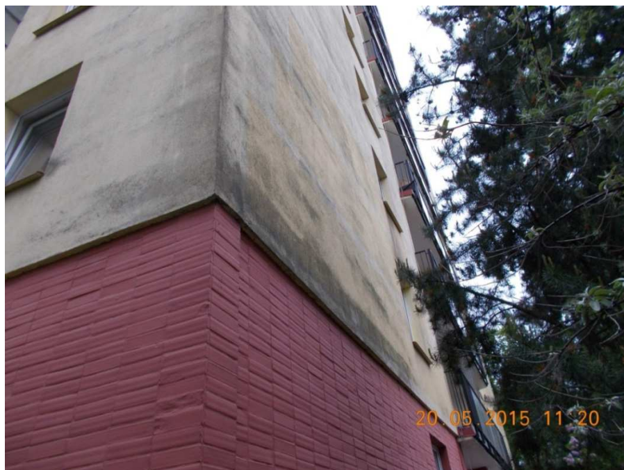
Obr. 3 Typický projev napadení fasádního líce konsorciem řas a plísní. Charakteristické jsou tmavě zbarvené skvrny. Toto místo je vhodné pro odběr vzorků.
