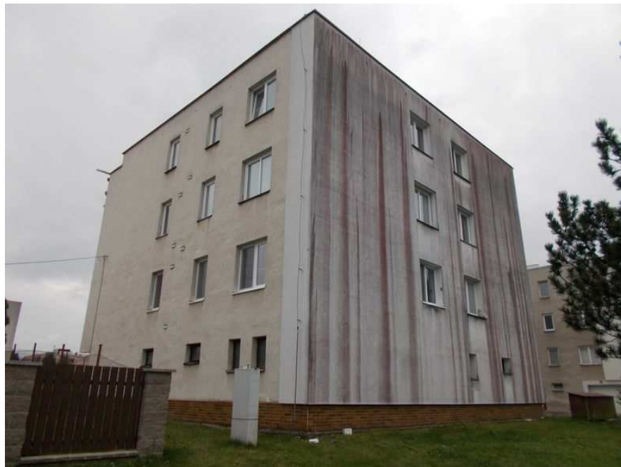
Obr. 6. Zjevně bioticky napadená fasádní plocha s orientací na sever. Jedná se o bytový dům se 4 nadzemními podlažími a s plochou střechou. Napadená je pouze kontaktně zateplená ( ETICS EPS, izolant tl. 80 mm) severní fasádní plocha. Stav na snímku potvrzuje hypotézu,
