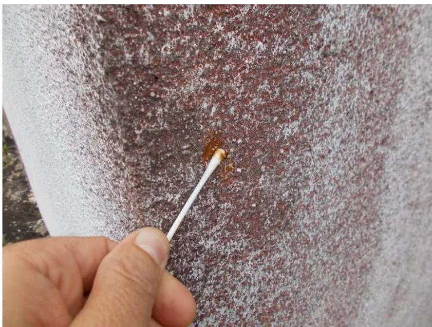
Obr . 11 První krok odběru stěrem – stěr „A“. Odebírají se biotické kultury na neporušeném povrchu fasádního líce. Úspěšný odběr signalizuje změna zbarvení stěrového tamponu.
