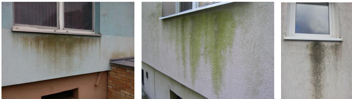
Obr. 8 – 10: příklady a důsledky špatně odizolovaného parapetního oplechování.
