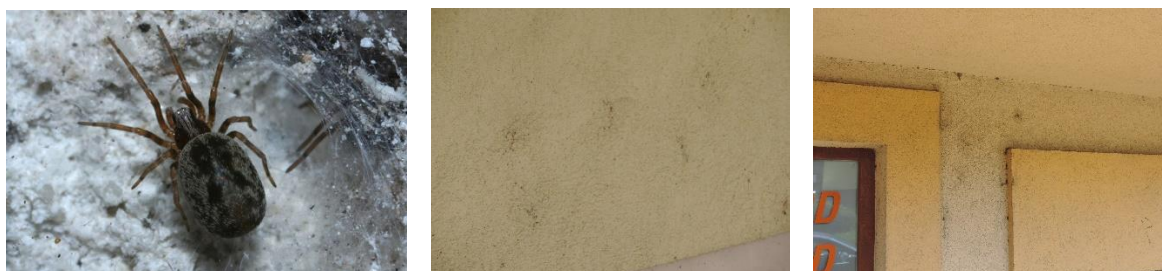
Obr. 26 – 28 původce a příklady pavučin na fasádě (obr. 26 - Daniela Procházková 2012).
