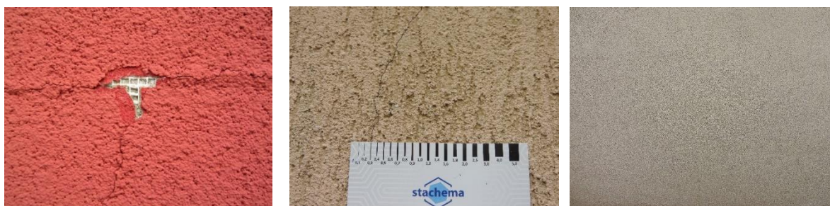
Obr. 27 – 29 příklady trhlin a prasklin na fasádě s ETICS.
