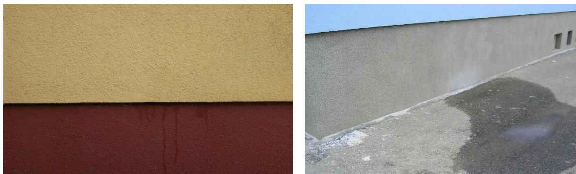
Obr. 30 – 31 příklady protékání vody izolantem nebo pod izolantem ETICS.
